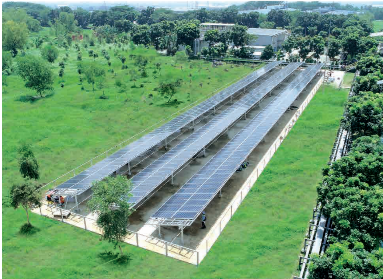
Teknologi Solar Photovoltaic 150 KWP berperan dalam mengkonversikan cahaya matahari menjadi tenaga listrik di kawasan Pabrik Karawang 1 The 150 KWP Photovoltaic Solar Technology converts sunlight into electricity power at Plant Karawang 1 area.
